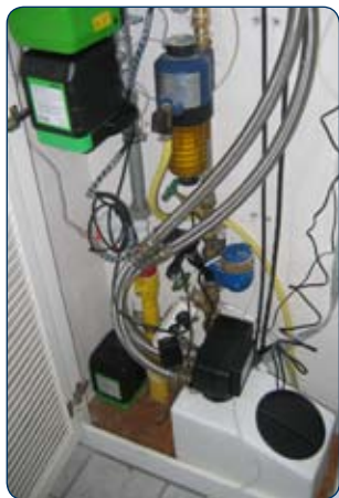
Sehr platzsparender Einbau einer Mini-Enthärtungsanlage in einem Wandschrank mit nachgeschalteter Dosierung
