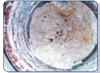
Verkalkter Warmwasserspeicher eines Einfamilienwohnhauses
