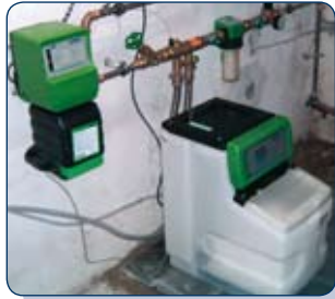
Enthärtungsanlage mit nachgeschalteter Dosierung
