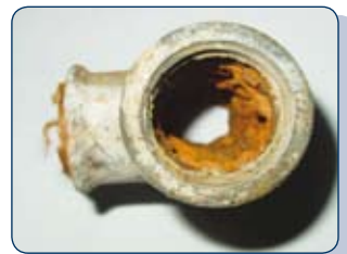
Kalk-Rost-Verkrustungen in einem verzinkten Stahlrohr (idealer Lebensraum für z.B. Legionellen)
